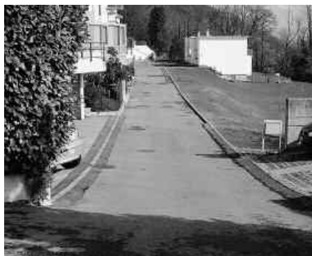
Via Campagna, dopo i lavori di sistemazione di un nuovo tronco di canalizzazione
