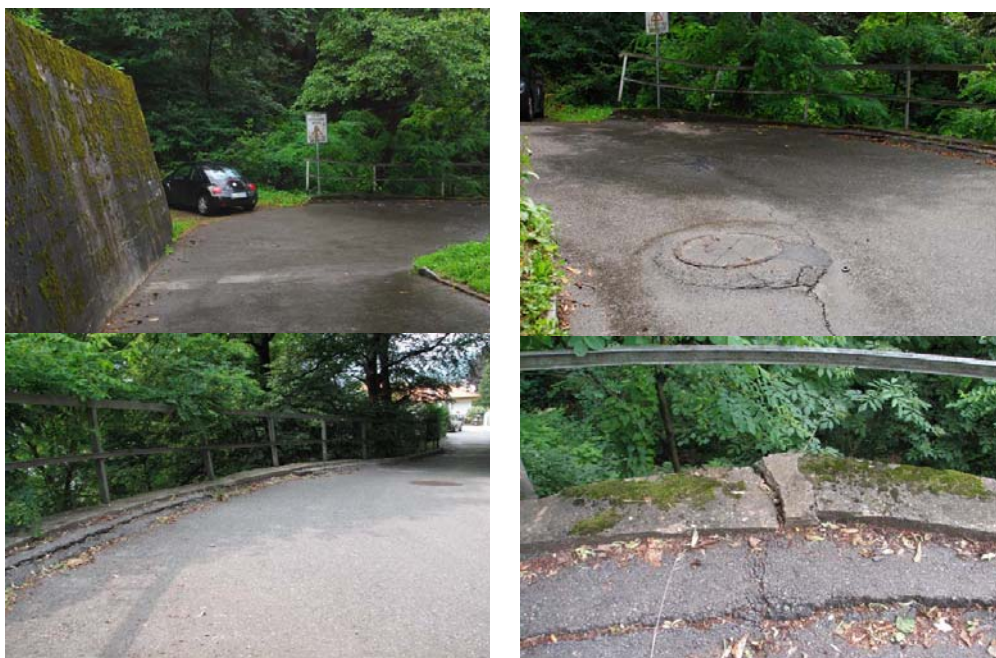
Figura 2: fotografie tornante e muro di sostegno via Minigera Campagna geognostica, situazione geologica e verifiche locale
